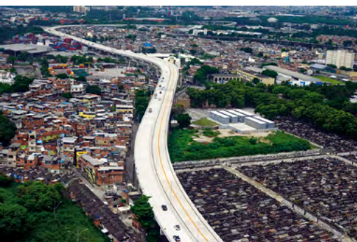
Alças da Ponte Rio-Niterói. O projeto da CRASA é a maior obra realizada na Rio-Niterói desde sua inauguração.
