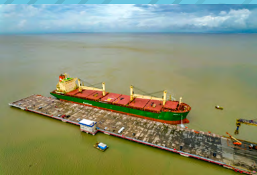
Projeto de implantação do Berço 99 – Porto do Itaqui, São Luís/MA. Cliente: Itacel/Suzano S.A. Gerenciamento: Timenow
